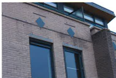
▲ Gevelvervuiling onder de loodslabbe
